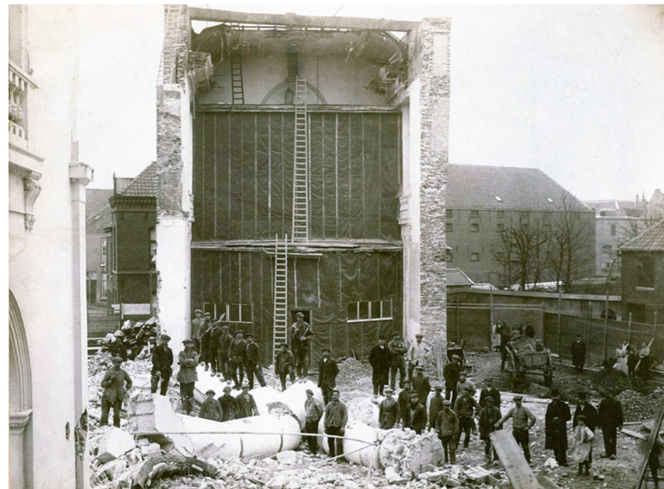
G.2 | Zicht op zangkoor westzijde, uit het Kasboek lezen we dat de eerste sloopwerkzaamheden zijn begonnen op 17 januari 1916. - BRON: BRABANT COLLECTIE UVT.
